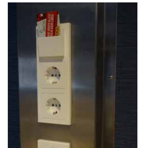
Op het moment dat gasten straks hun hotelkamer betreden en hun toegangspas in de hotelkaartschakelaar steken, schakelen automatisch de klimaatinstallaties en verlichtingsarmaturen in.
